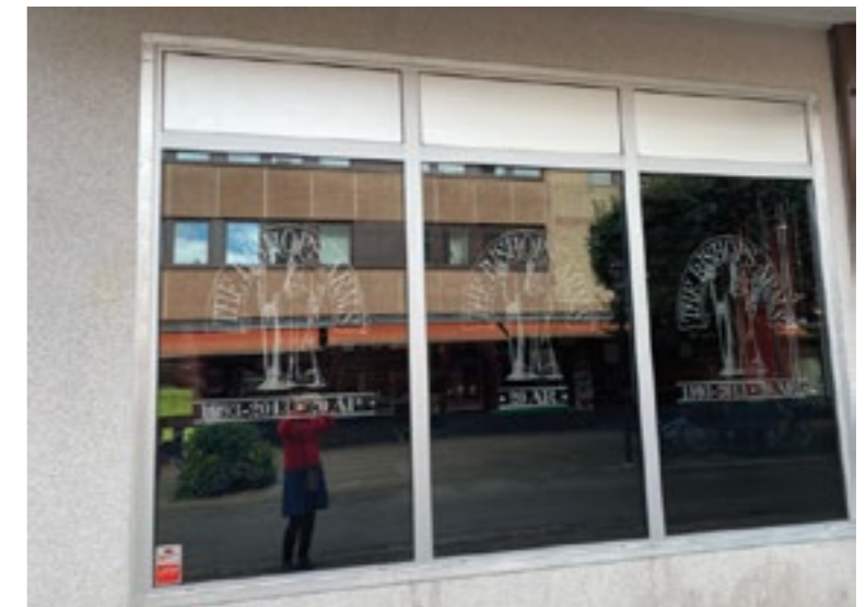
11. Aluminiumparti längs Stora gatan som bör återställas.
